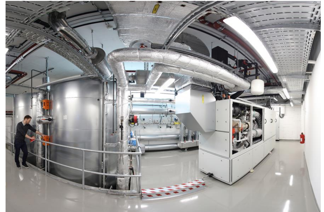
© Kurt Fuchs / Fraunhofer IISB. KWK-Anlage am Fraunhofer IISB Wärmespeicher (links) und BHKW (rechts)
