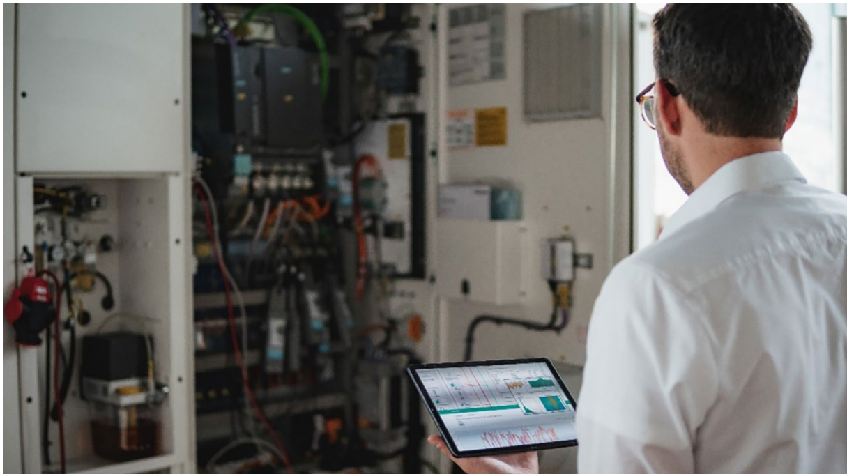
Mobile Messungen an einer Anlage, für welche noch keine archivierten Messdaten zur Verfügung standen. Bild: C. Hoffmann / Fraunhofer IPA
